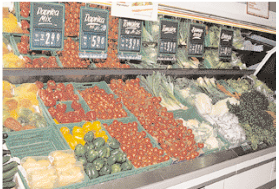
Abb. 5: Verkaufsmöbel mit Luftbefeuchtung. Ein mit dem Auge kaum sichtbarer Kaltnebelschleier legt sich über das Gemüse.
