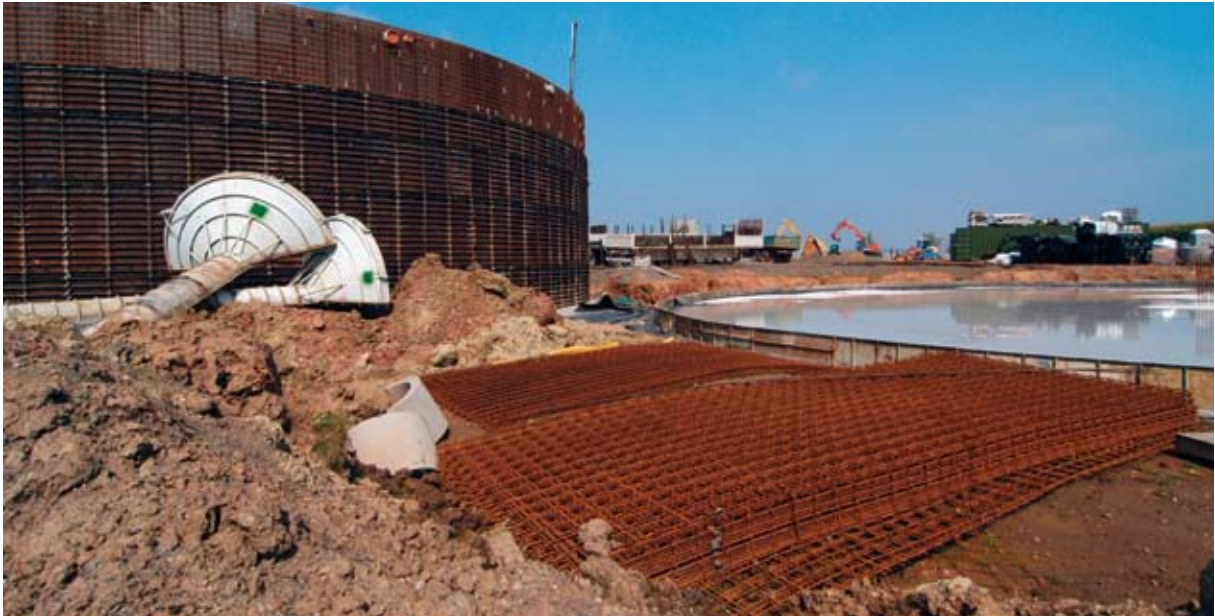
Biogas boomt – aufgrund des novellierten Erneuerbare-Energien-Gesetzes (EEG) ist zu erwarten, dass im Jahr 2009 etwa 800 neue Biogasanlagen errichtet werden.
